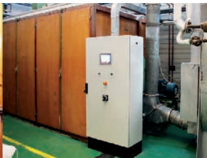
除塵 Dedusting Odpylanie
